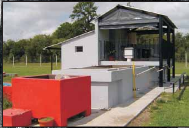
f Foto 12.14. Reactores anaeróbicos para el tratamiento de residuos sólidos (Tipo vertical) (INTA Castelar – IMyZA)
